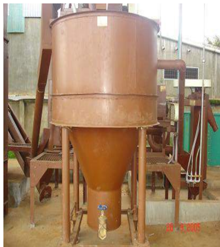
Hình 84: Bể siphon kim loại
